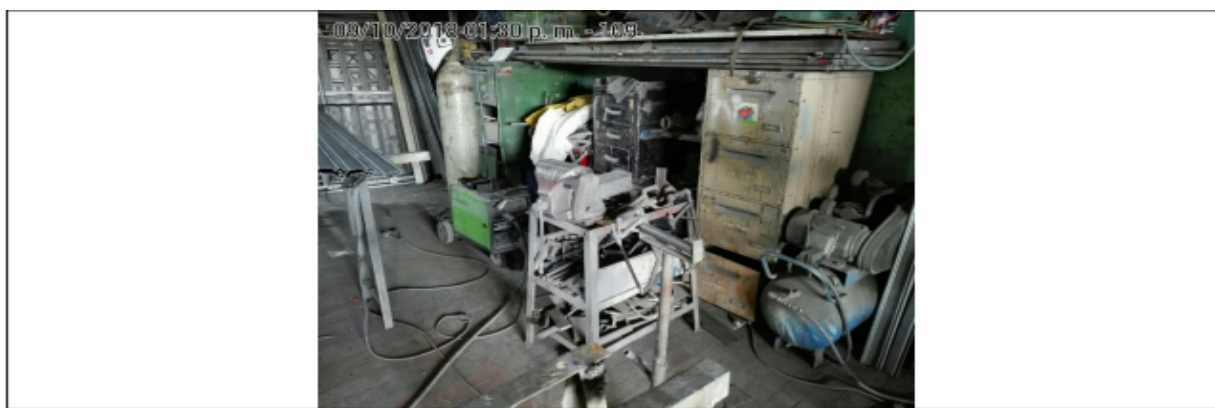
FOTOGRAFÍA N°. 5 COMPRESOR Y PRENSA
